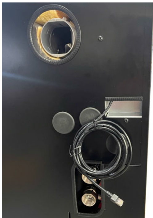
Sl. 9-36: Kabel LAN
